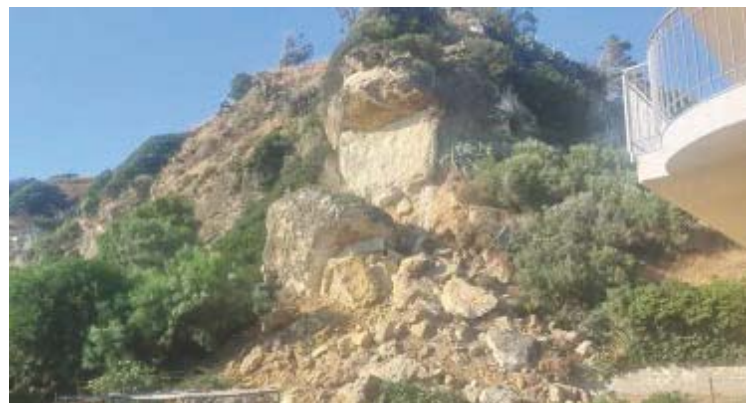
Il costone di roccia staccatosi a Torre Lupo di Falerna marina
