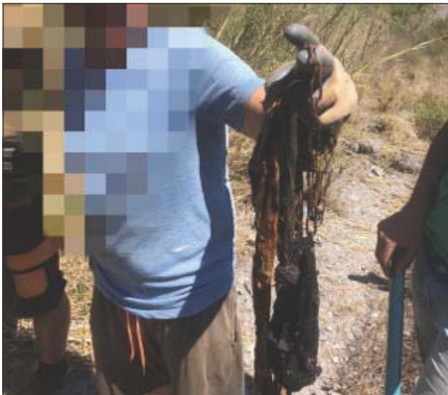
Stracci e catene trovati nelle tubazioni dell'acqua potabile
